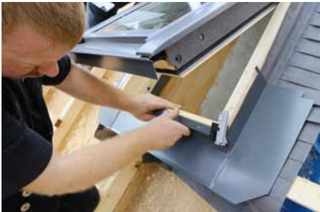
Für das Anarbeiten an die Dachdeckung wurde ein spezieller Eindeckrahmen für flache Deckungen genutzt.
